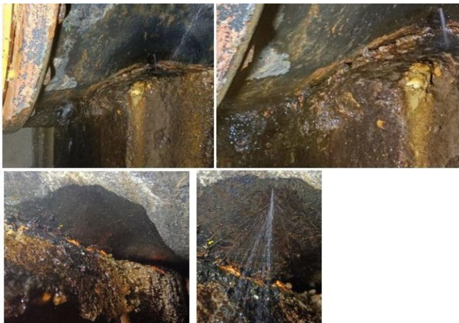
Deterioro de las válvulas de la presa de Eiras, que suministra a Vigo y a varios municipios del área.. AUGAS DE GALICIA
